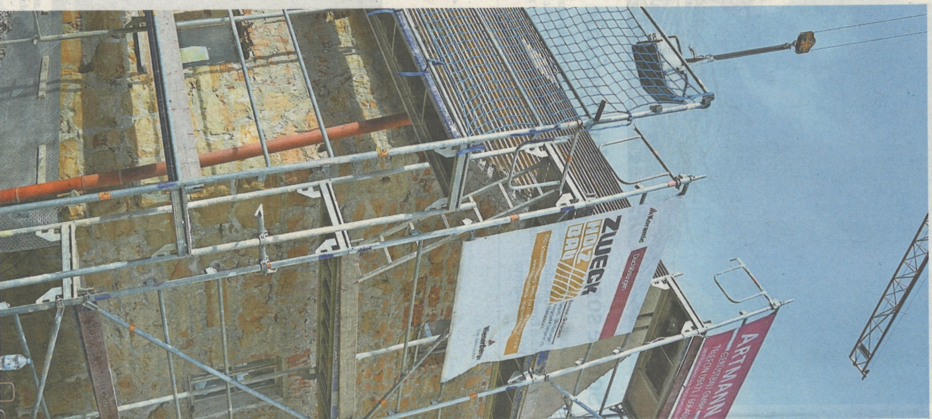
Seit Dienstag ist das Türmerhaus eingetretet. Der marode Dachstuhl muss komplett erneuert werden, sagt OWV-Vorsitzender Erwin Mayer. FOTO: HEINZL
